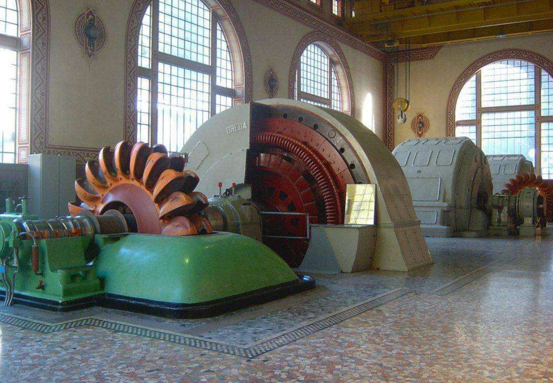
Carona: centrale idroelettrica
